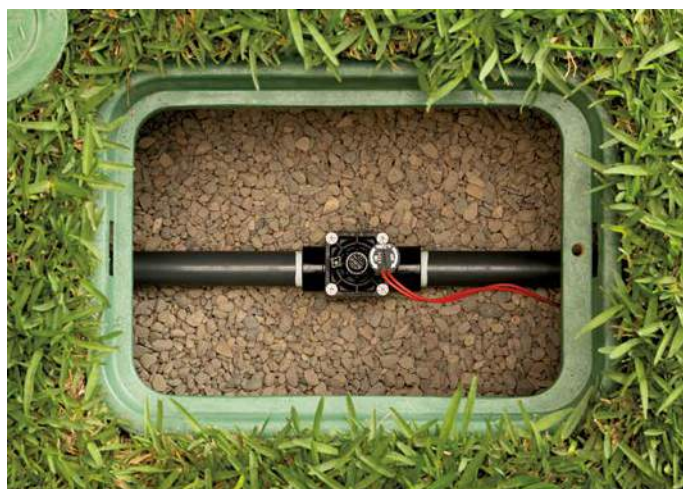
PGV-100G Ventile installiert
