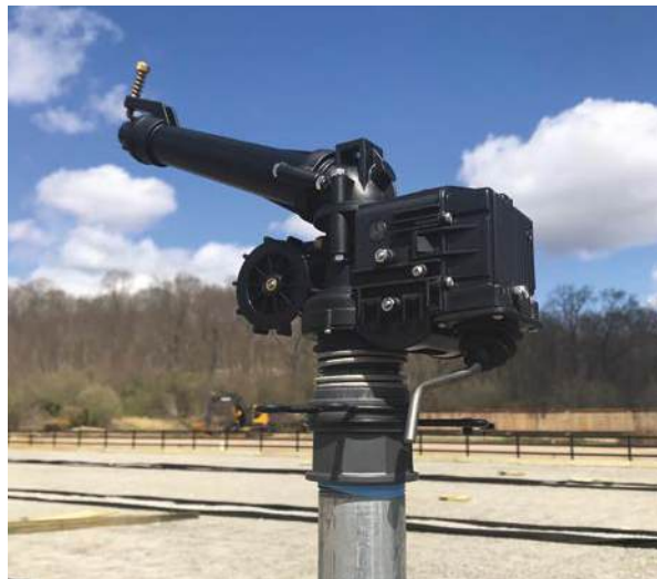
ST-1200-BR Getrieberegner installiert
