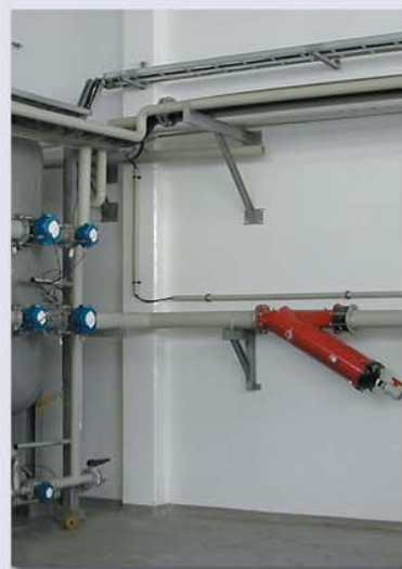
▲ Filtrazione acqua di raffreddamento. Fabbrica alimentare, Israele
