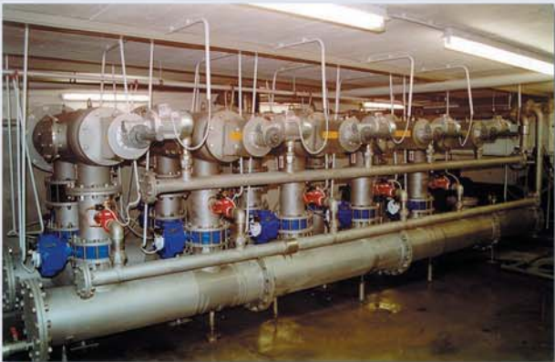
▲ Eau potable, 1000m 3 /h, 50µm. Hallertau, Allemagne
