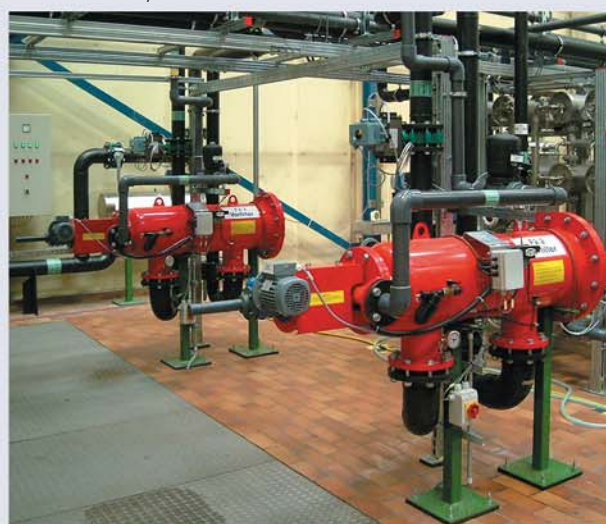
▲ Pré filtration Osmose inverse, 45m 3 /h, 10µm. Usine chimique, Allemagne
