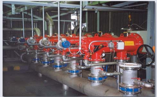
▲ Circuit principal de refroidissement usine plastique, 680m 3 /h, 100µm. Troisdorf, Allemagne
