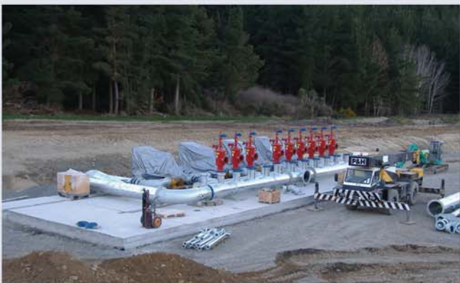
▲ Protection anti gel, eau de barrage. 7 200m 3 /h, 500 microns. Projet ARA, Nelle Zélande
