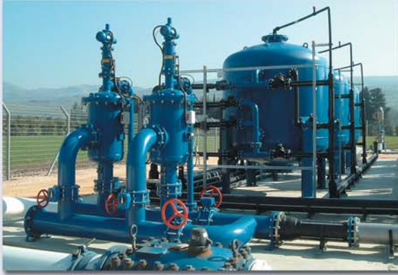
▲ Pré filtration usine de potabilisation. 375m 3 /h, 50 microns. Rivière Dan, Israël
