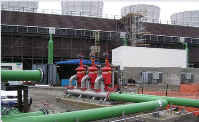
▲ Eau de tour de refroidissement sur circuit dérivé. 360m 3 /h, 25 microns. Centrale électrique Huntley, Nelle Zélande
