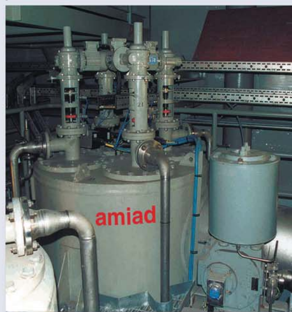
▲ Eau d'injection. 2 000m 3 /h, 50 microns. Plateforme de la Mer du Nord
