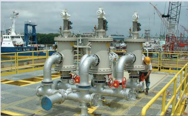
▲ Application eau de mer: Filtration eau d'injection. 220m 3 /h (970 GPM), 200 et 25 microns. A bord d'un "FPSO"
