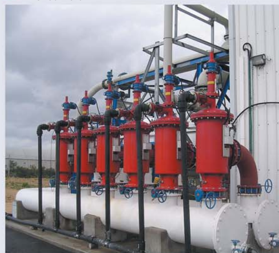
▲ Pré filtration membranes osmose inverse. 1 700m 3 /h, 25 microns. Usine de désalinisation, Israël
