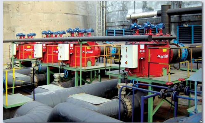
▲ Tour de refroidissement, aciérie. 16 000m 3 /h, 200 microns. Chine du sud.
