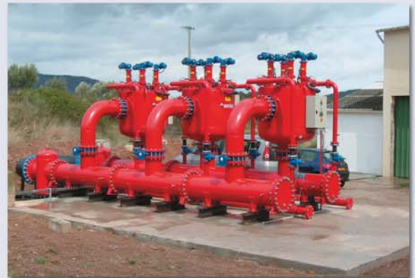
▲ Eau d'irrigation. 1 800m 3 /h, 50 microns. Narbonne, France
