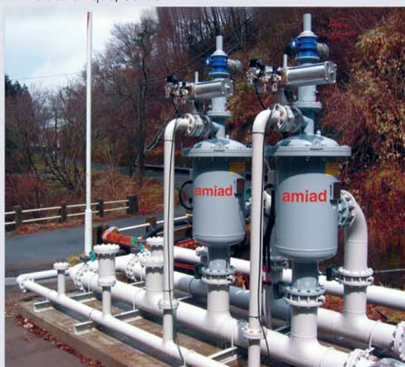
▲ Eau de rivière pour Spa eau chaude. 170m 3 /h, 25 microns. Japon
