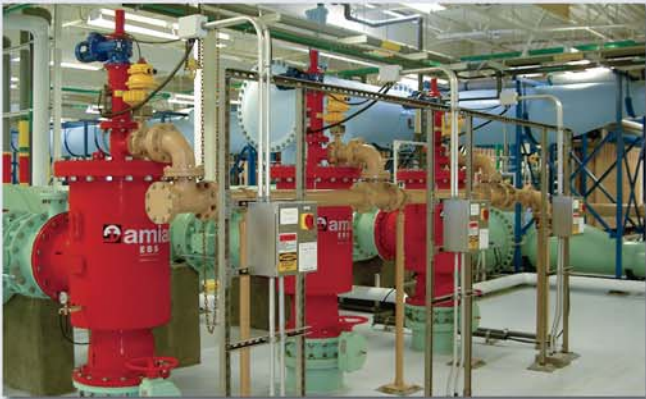
▲ Pré filtration membranes. 3 000 m 3 /h (13 000 GPM), 300 microns. Eau de rivière clarifiée. Olathe, KS. USA
