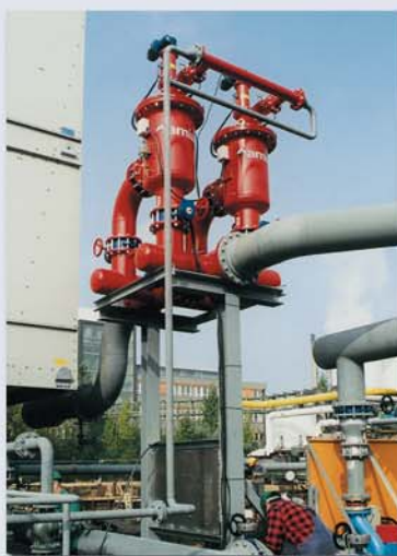
▲ Eau de refroidissement usine pétrochimique. 460m 3 /h, 130 mic. Hambourg, Allemagne
