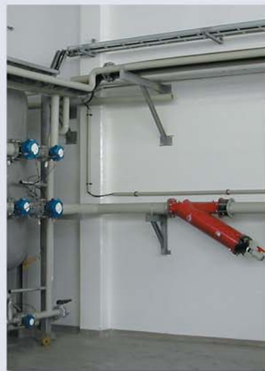
▲ Filtration eau de refroidissement. Industrie alimentaire, Israël
